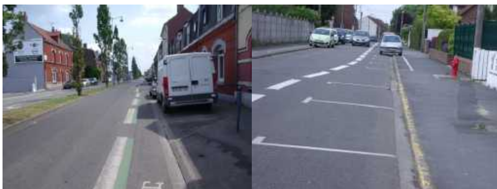
Exemples de dysfonctionnement deux roues : des itinéraires cyclables avec des emprises insuffisantes qui pénalisent la sécurité des deux-roues
