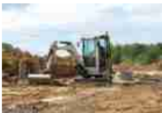
25 mai 2022 ZAC du Chemin de l'Abbaye à Vendin les Béthune – Démarrage de la première phase de viabilisation
