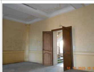
Traces de moisissures sur les murs
