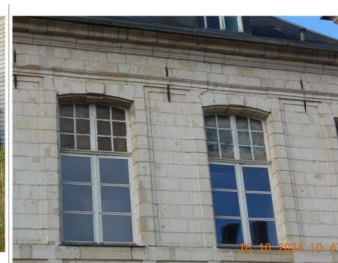
Problèmes de fissures en façade
