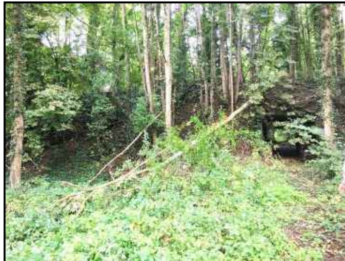
Tunnel béton sous merlon conquis par la végétation
